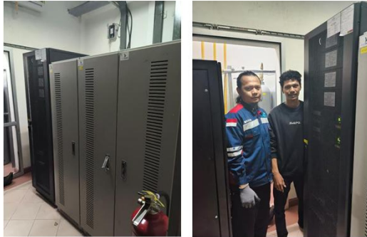
Gbr. 4 Unit UPS Modular 90 kVA dan Instalasi Bank Baterai.
