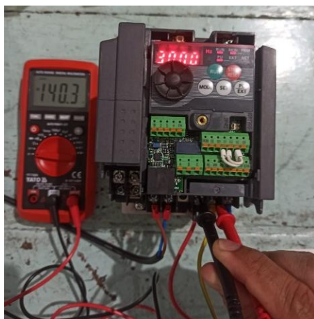
Gambar 9. Pengukuran Tegangan Output VFD
