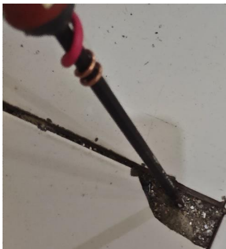
Gbr.10 Konduktor yang terhubung dari mesin pompa sebagai simulasi arus bocor pada mesin pompa
