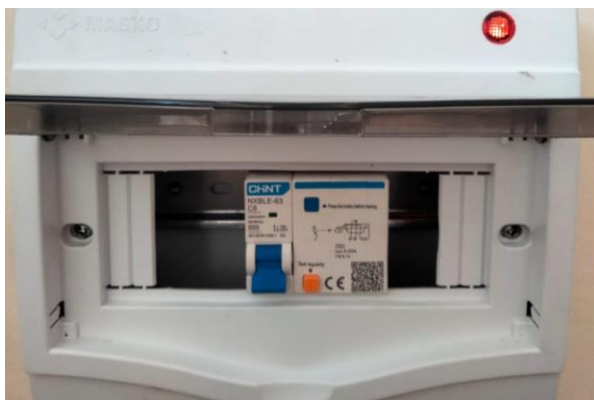
Gbr. 11 Kondisi RCBO setelah terjadi arus bocor
