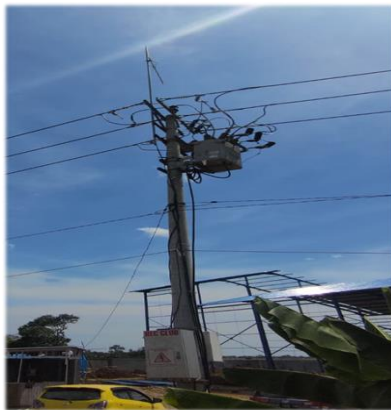
Gbr. 1 Recloser Penyalang Pajalau
