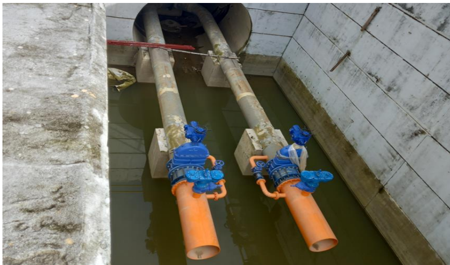
Gambar 6. Foto dokumentasi pipa bottom outlet
