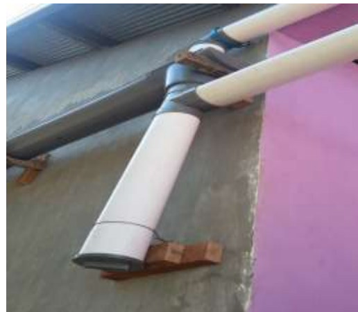
Gambar 3. Pipa Pembuangan Air
